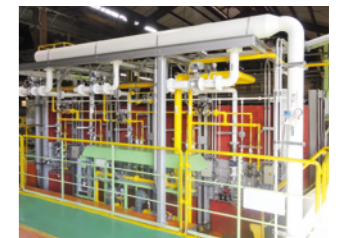
バーナーを導入した鋼材熱処理炉
