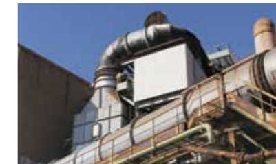
鉄を溶かした熱を再利用 電気炉の排熱を、ボイラーを通して蒸気エネルギーとして回収し、真空脱ガス装置などの他設備で有効活用する仕組みを導入することで、CO 2 削減へ貢献します。
