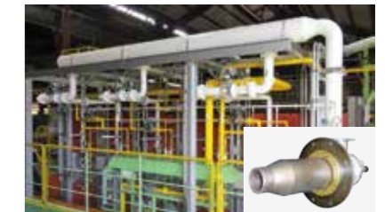
水素燃焼の実用化に向けて 刈谷工場では鋼材熱処理炉に水素・都市ガス兼用バーナーを導入しており、今後、水素燃焼技術の開発、実証実験を経て、水素燃焼の実用化を目指していきます。
