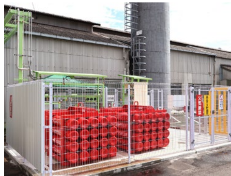
水素貯蔵設備
