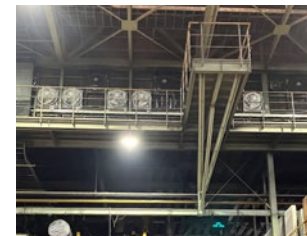
暑熱対策(建屋冷風循環)
