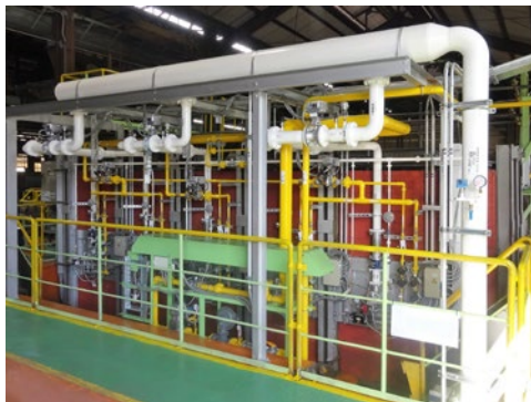
水素燃焼実証試験を行う鋼材熱処理炉
